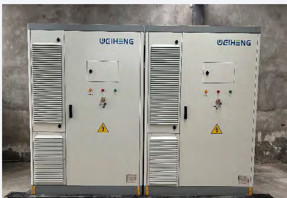
浙江恒拓高分子 储能项目
