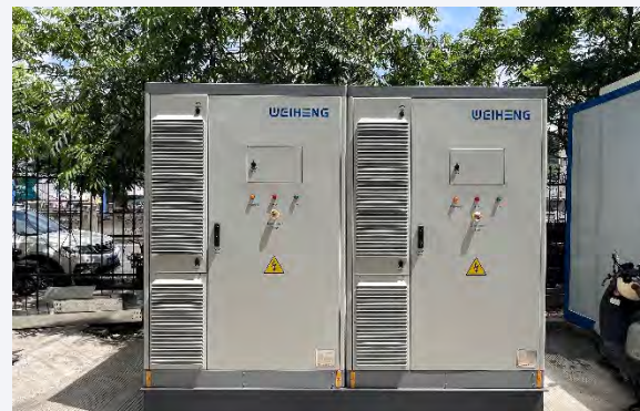
浙江千艺 储能项目
