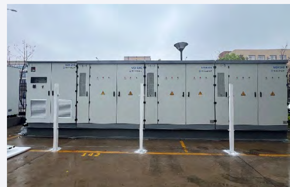
浙江锦盛新材料 储能项目
