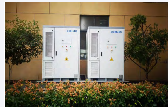
浙江越港包装 储能项目
