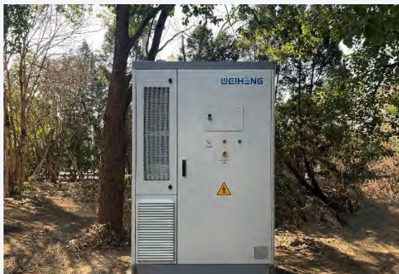
上海百家宴 储能项目
