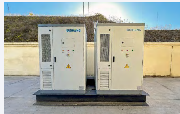
山西蔡家崖收费站 光储充一体化项目
