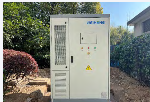
浙江飞羚电气 储能项目
