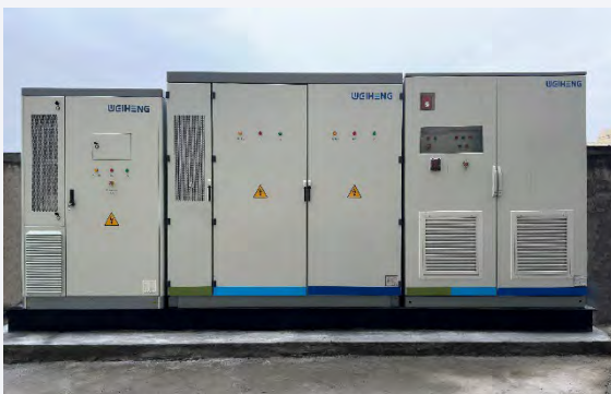
浙江泰山 储能项目
