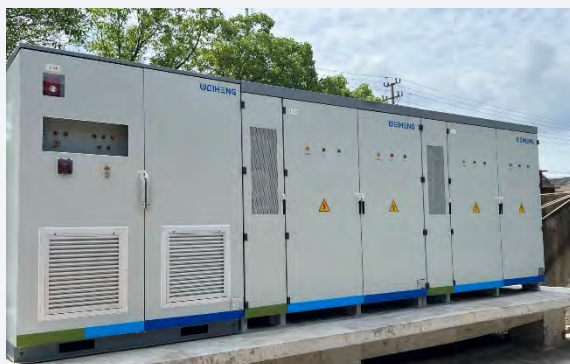
浙江中杭磁材 储能项目
