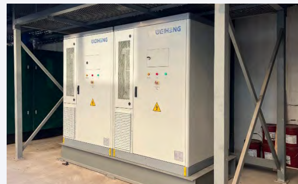
浙江帛川纺织 储能项目
