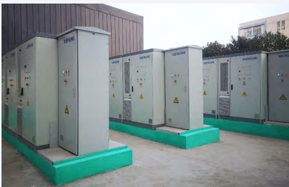
浙江楚商针纺 储能项目
