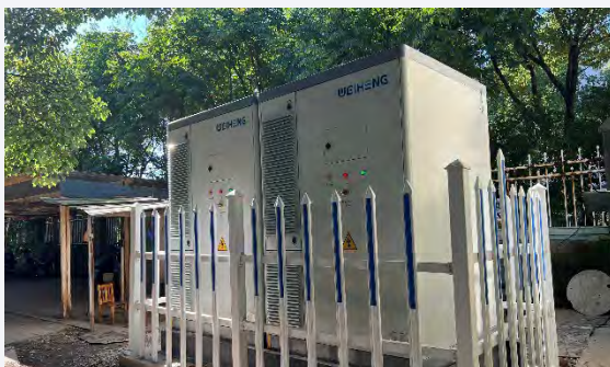
江苏润昌机械设备 储能项目
