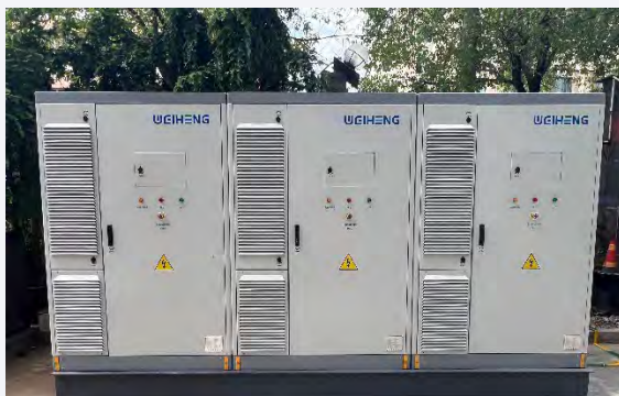
浙江鼎丰 储能项目
