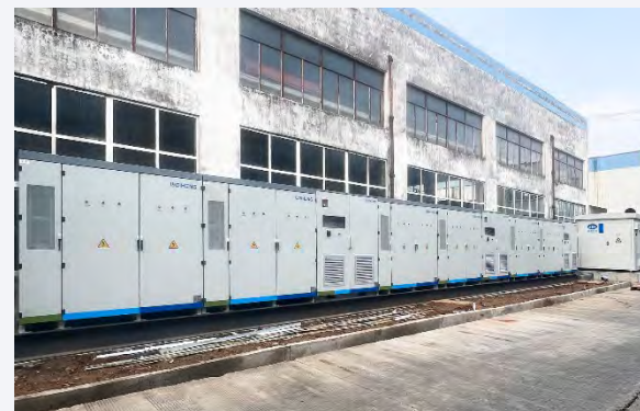
浙江宁力紧固件 储能项目
