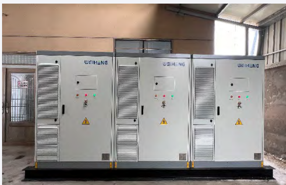
浙江睿科 储能项目
