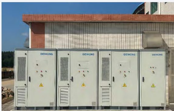
广东荣华 光储一体化项目
