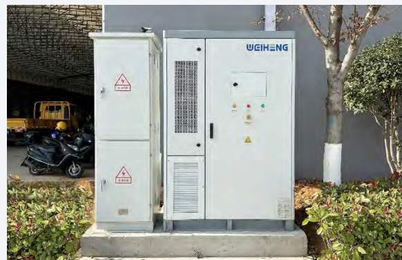
江苏宇超电气 储能项目
