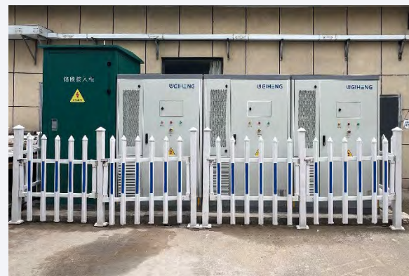
浙江和惠照明 储能项目
