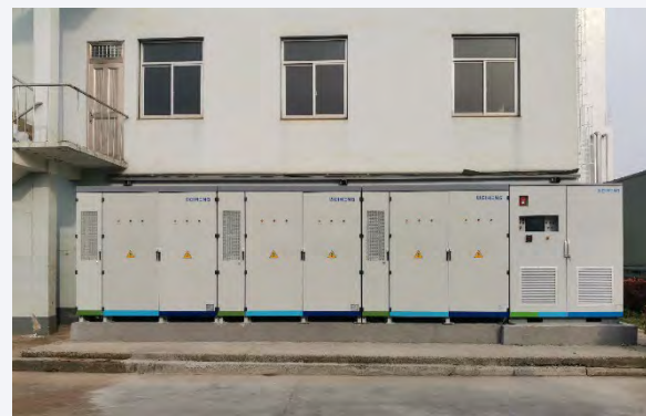
浙江金轮磁材 储能项目
