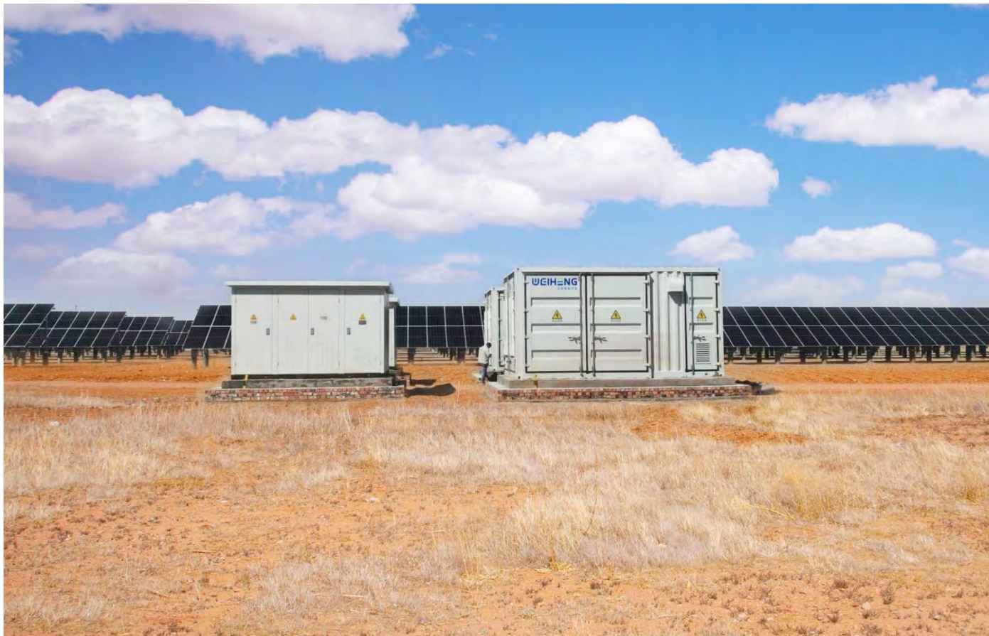
内蒙古阿拉善盟光储项目
