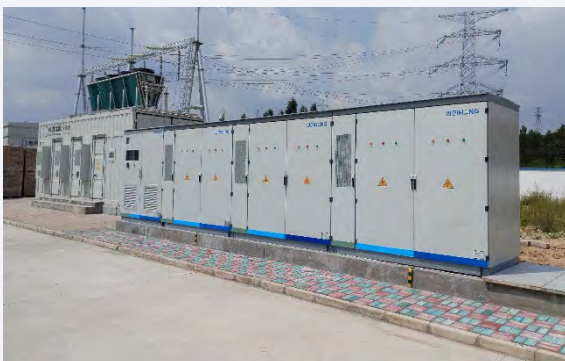
山西格盟国际 储能项目
