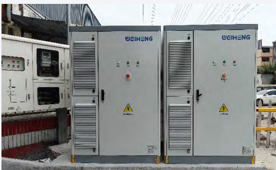
广东恒泰源物业 储能项目
