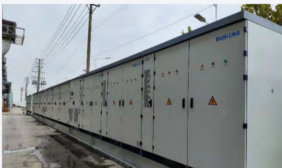
湖北永润薄膜 储能项目
