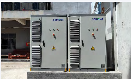
广东东泓 储能项目
