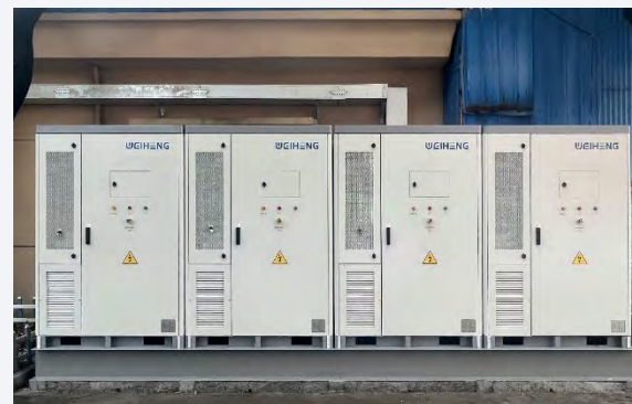
浙江宏阳 储能项目
